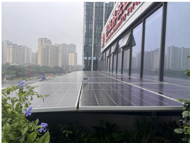
公共花坛区域新增的光伏发电设施
