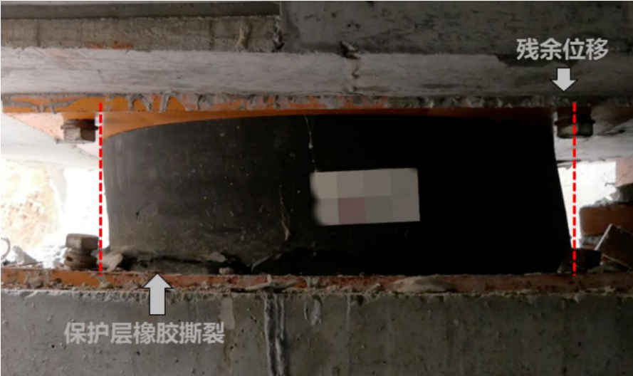
震中某隔震建筑，支座出现撕裂、残余变形等现象
